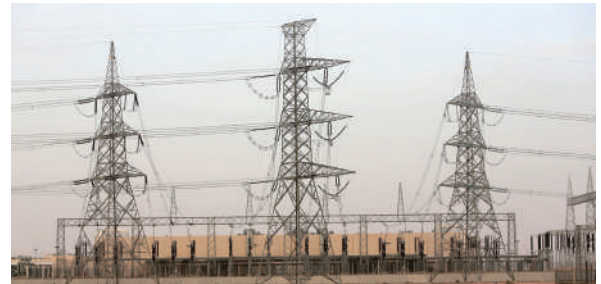
محطة سدبير لتحويل الكهرباء
