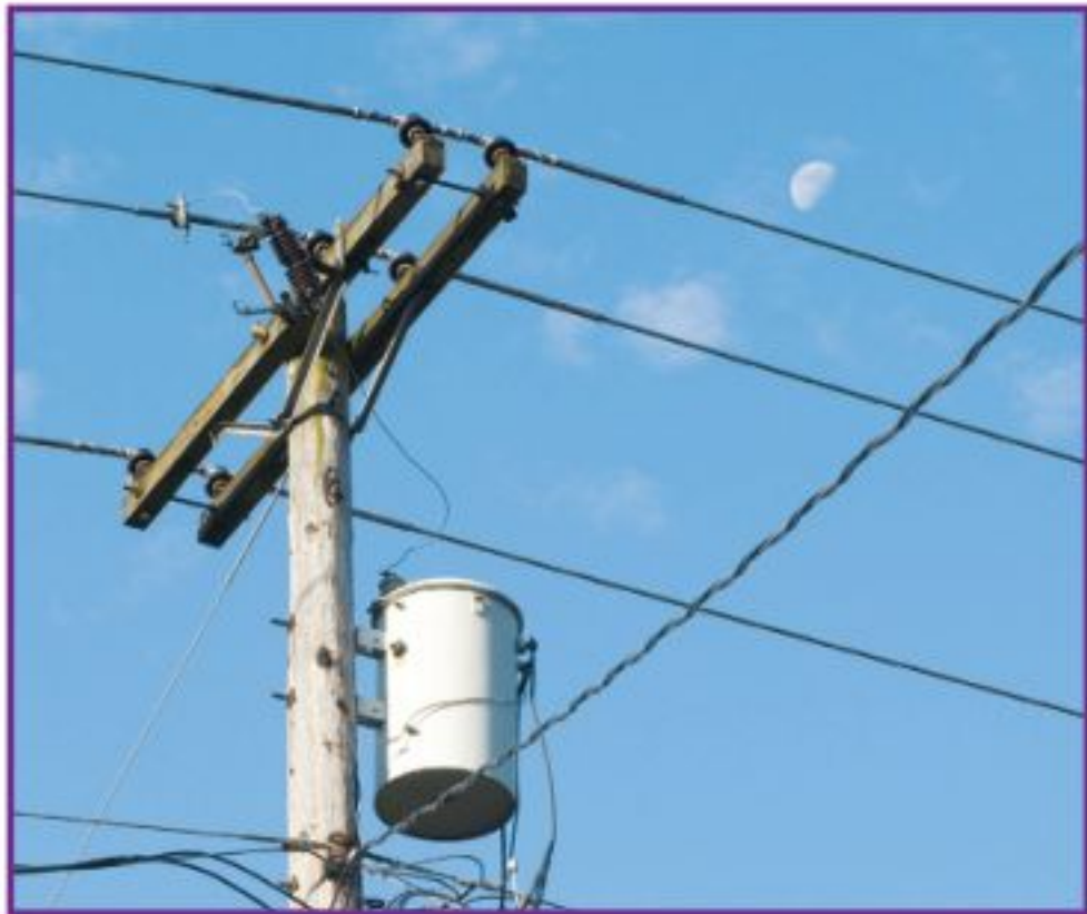
هناك أدوات تُسمى المحولات تستعمل المغناطيسية لخفض التيار الكهربائي إلى قدرٍ مناسبٍ ليستخدم في المنازل..
