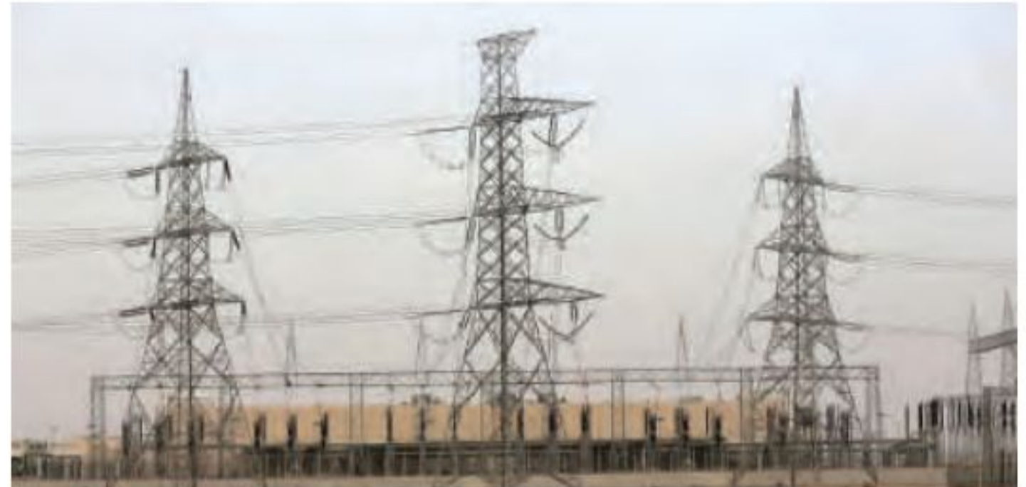
محطة سدير لتحويل الكهرباء
